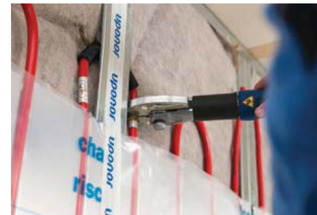
DE UPONOR LEIDINGEN WORDEN GEKOPPELD IN DE WONING
